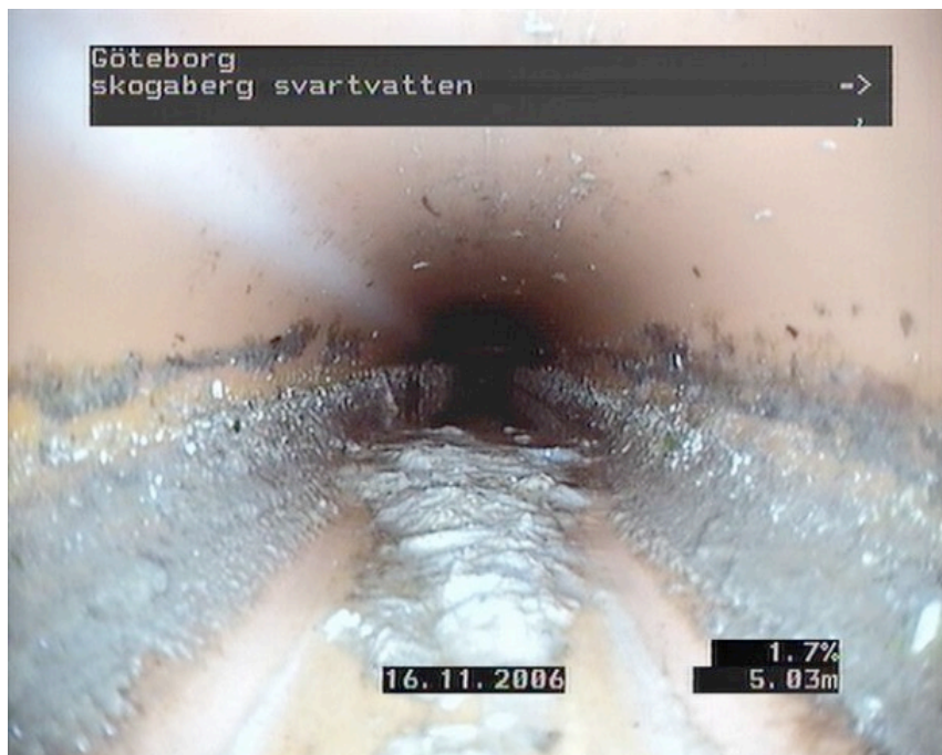
Figur 19. Bild från filmning av spillvattenledning långt upp i självfallssystemet med avlagringar upp till centrum ledning (Karlsson m.fl. 2008).
