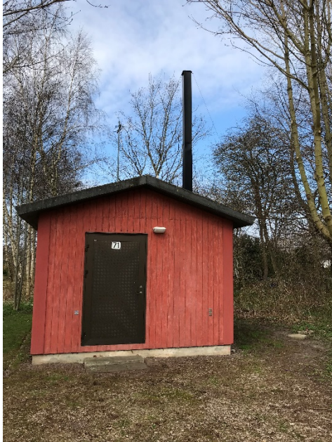
Figur 20. Bild på vakuumpumpstation SP71 i Farhult med skorsten. Foto: Helena Mårtensson, 2018.
